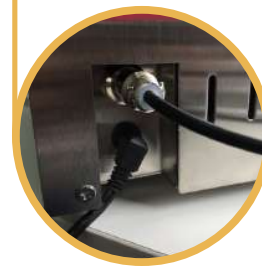
Подключение: Питания (DC 24V) Системы "Умный дом"
